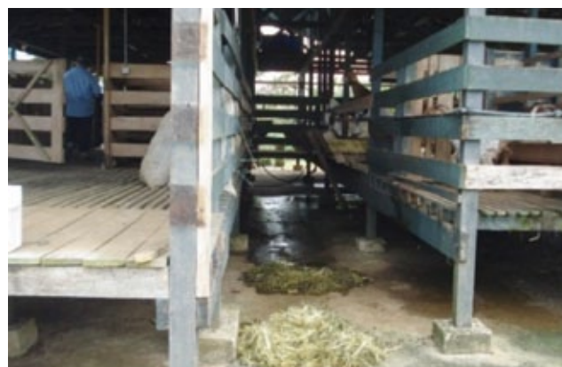
Rajah 3. Lantai kandang terlalu rendah.
