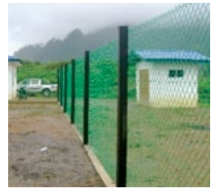
Rajah 22. Pagar perimeter kandang.
